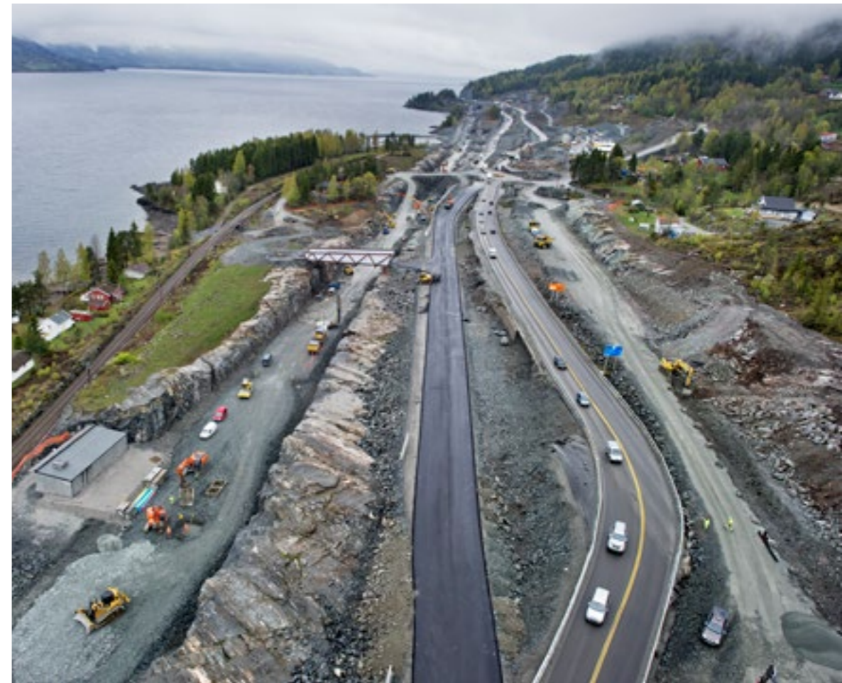
Bilde viser E6-Dovrebanen ved Mjøsa der den gamle linja er i bruk samtidig som nytt blir bygd på sida.
